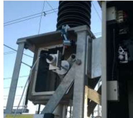
安装在ABB LTB 245 kV SF6断路器的数字旋转转换器
